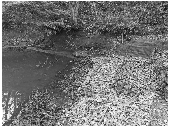
②修復予定の谷戸の池の水漏れ箇所
